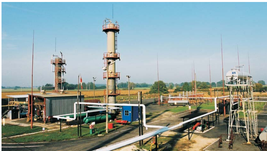
Ryc. 2. Instalacja oczyszczania gazu z Kopalni Gazu Ziemnego Borzęcin , wraz z zespołem powrotnego zatłaczania gazów kwaśnych, zawierających około 60% CO 2 . Fot. K. Moroz
