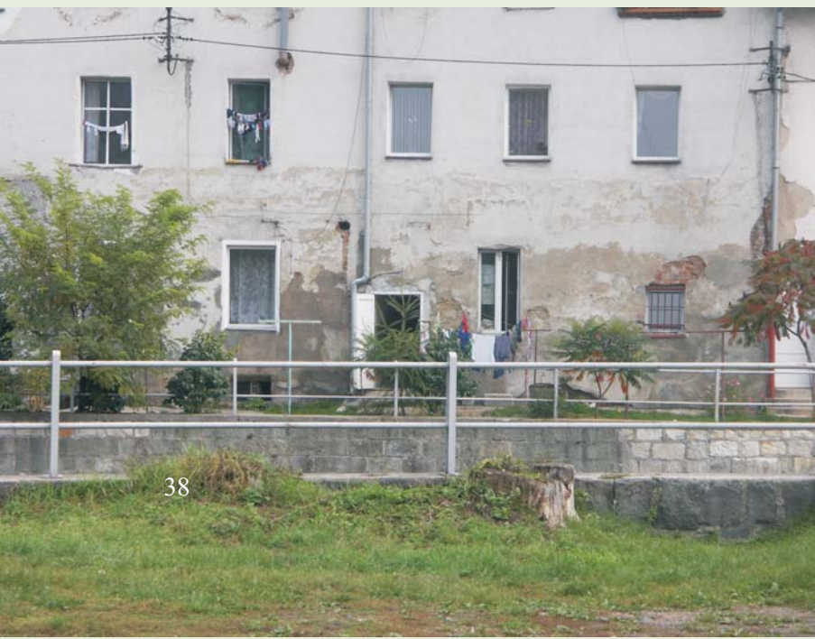
Fot. 7. Poziom, jaki osiągnęły wody powodziowe Nysy Kłodzkiej w 1997 r. nadal widoczny na ścianach niektórych budynków w Kłodzku. Fot. S. Cwojdzński
