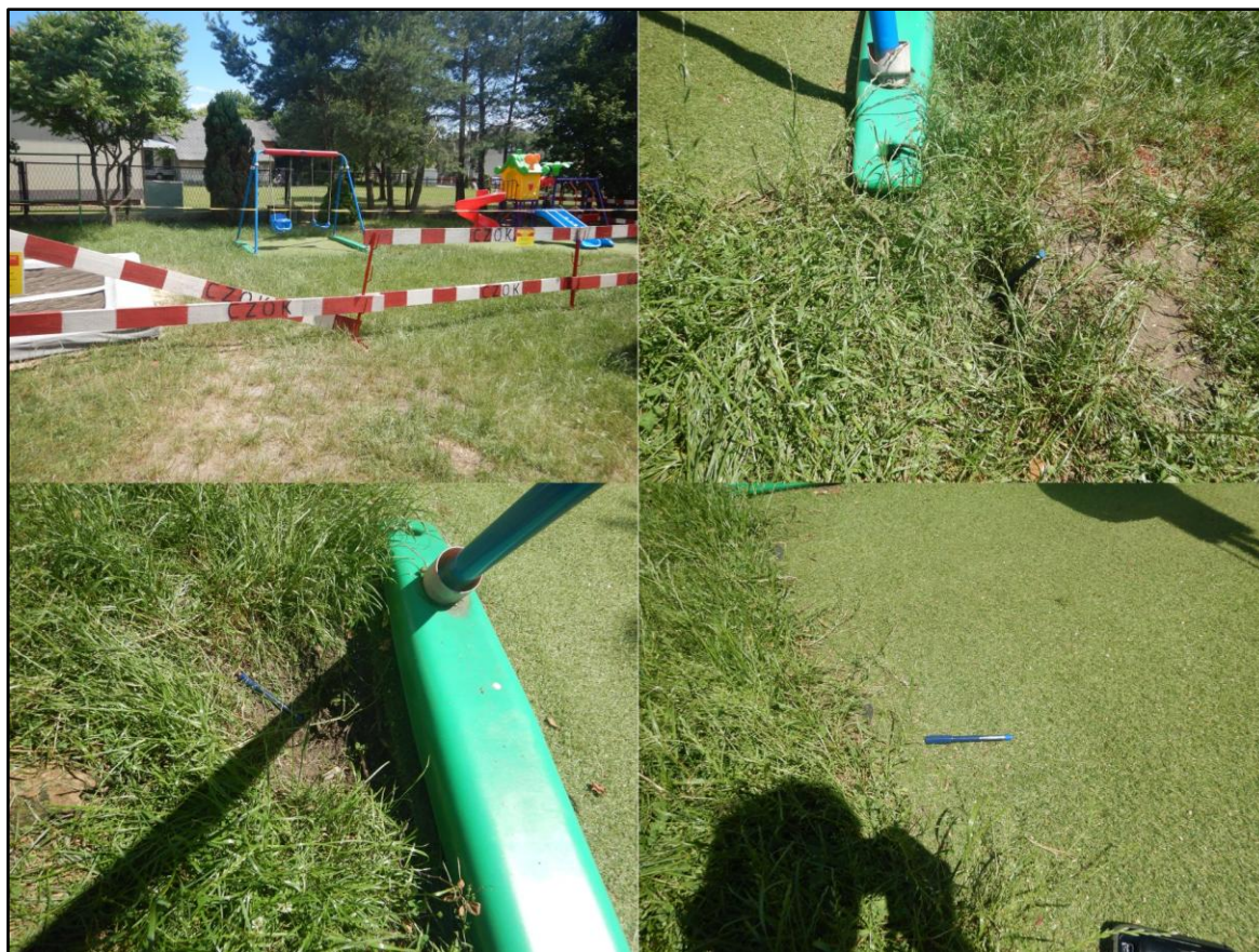
Fot. 9. Widok na obniżenia terenu na terenie Przedszkola Samorządowego nr 3 przy ul. Grunwaldzkiej (fot. S. Kamieniarz)
