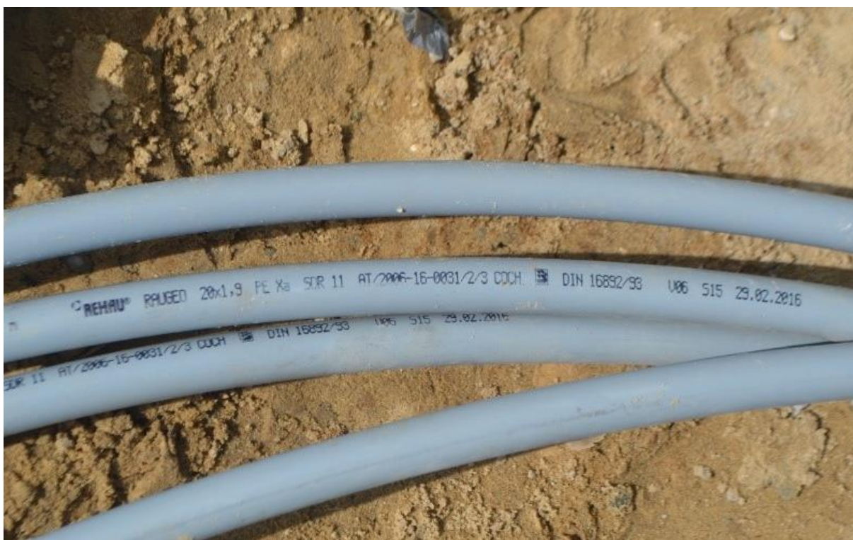
Rysunek 80 Rurki wymiennika ciepła zamontowane w termopalach (Laboratorium Energetyki, AGH)
