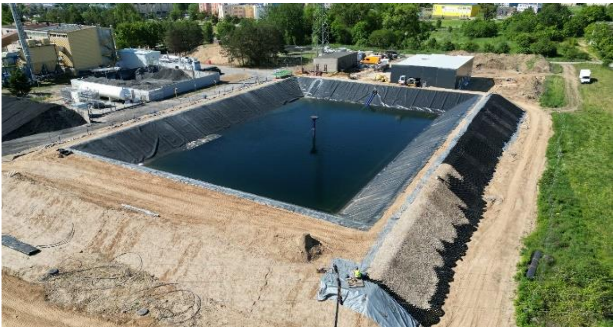
Rysunek 38 Napelnianie wodą z sieci wodociągowej (Euros Energy)
