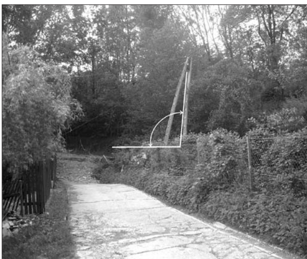
Ryc. 11. Odchylenie słupa od pionu przeciwne do nachylenia stoku osuwiskowego
