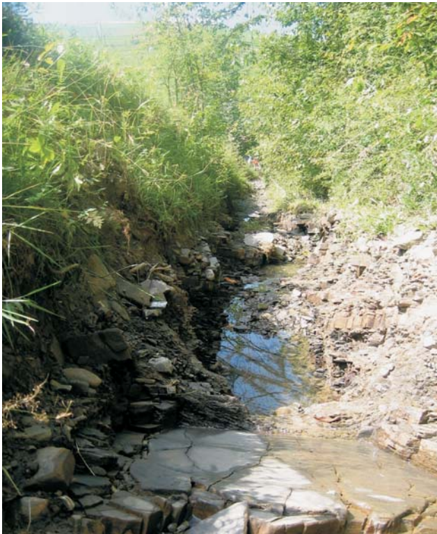
Ryc. 4. Drogowie rozcięcie erozyjne zniszczone przez działalność erozyjną splywu gruzowo-błotnego Fig. 4. The road's cut surface destroyed by erosional activity of debris flow
