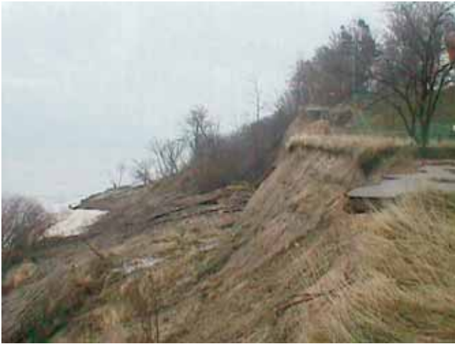
Fig. 5. Landslide on Jastrzębia Góra Cliff, January 1999 (Photo. by Sz. Uścińowicz)
