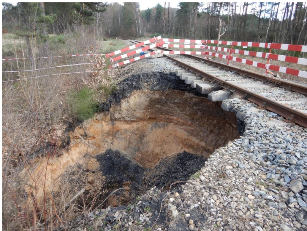
Ryc. 108. Widok na lej zapadliska (fot. PIG-PIB).
