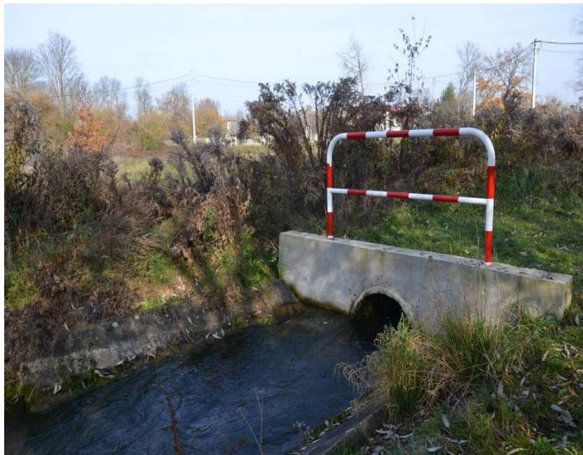
(wylot i kanał do rzeki Hutki z kopalni Miedzianka - fot. J., Bruczyńska, 2023 r.)
