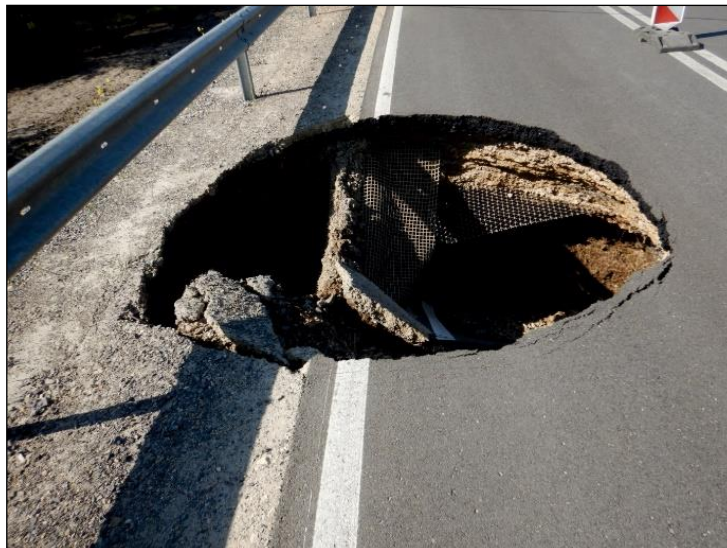
Fot. 4.1. Zapadlisko w obrębie korpusu drogowego
