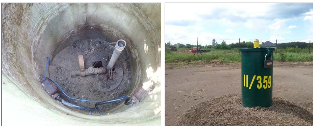
Ryc. 39.7 Punkt sieci obserwacyjno-badawczej wód podziemnych II/359 Polnica (woj. pomorskie) – stan przed i po wykonaniu prac modernizacyjnych
