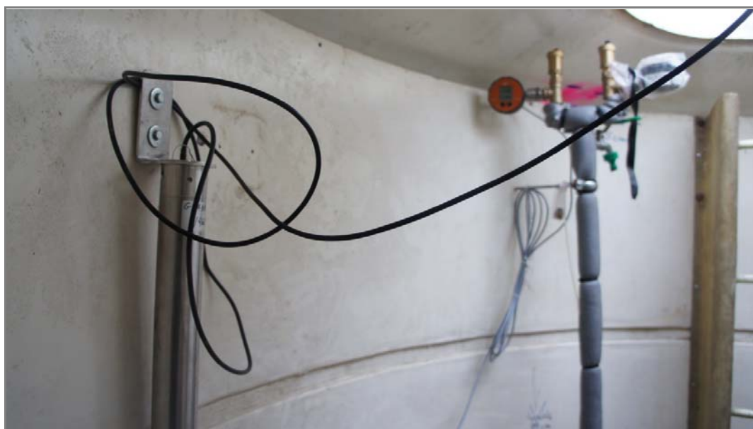
Ryc. 3.2. Rejestrator cyfrowy LEO- 1 firmy Keller (manometr) połączony z modulem transmisji danych pomiarowych GSM-2 Keller - stacja hydrogeologiczna w Granicy I/960/1.
