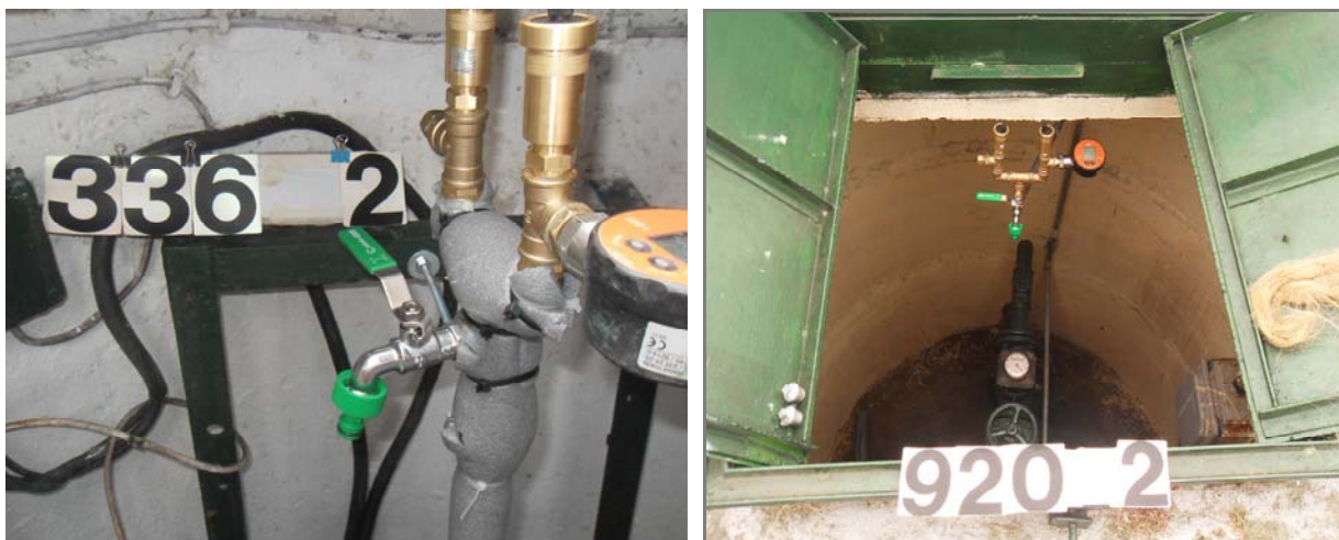
Ryc. 39.6 Otwory obserwacyjne z samowypływem I/336/2 Białowieża (woj. świętokrzyskie) i I/920/2 Sepno (woj. wielkopolskie) z instalacją przystosowaną do montażu automatyki pomiarowej
