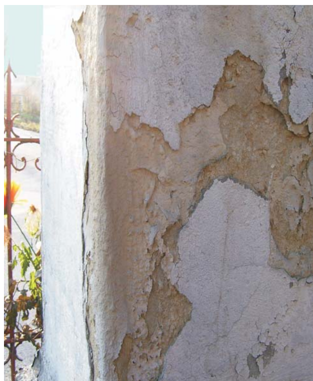
Ryc. 8. Fragment Figury Chrystusa Ukrzyżowanego, z 1876 r. (skrzyżowanie ulic Myślenickiej i Cechowej), fundacji gminy Kurdwanów. Zjawisko odpajania się zewnętrznej warstwy piaskowca pokrytego farbą. Wszystkie fot. M. Sowa
