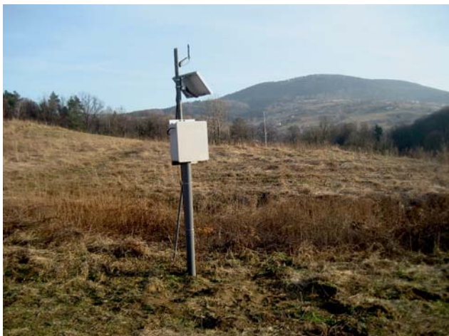
Ryc. 7. Stacja inklinometrów in-place i piezometrów on-line Fig. 7. In-place inclinometer and piezometer on-line station
