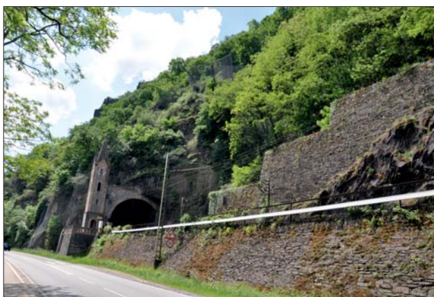
Ryc. 1. Zabezpieczenie przed osuwiskami tunelu kolejowego DB w rejonie Oberwesel – w dolnej części widoczne ponad stuletnie mury oporowe z kamienia łamanego, w górnej nowoczesne elastyczne bariery przeciwrumowiskowe. Wszystkie fot. M. Lauterbach, czerwiec 2017 r.
