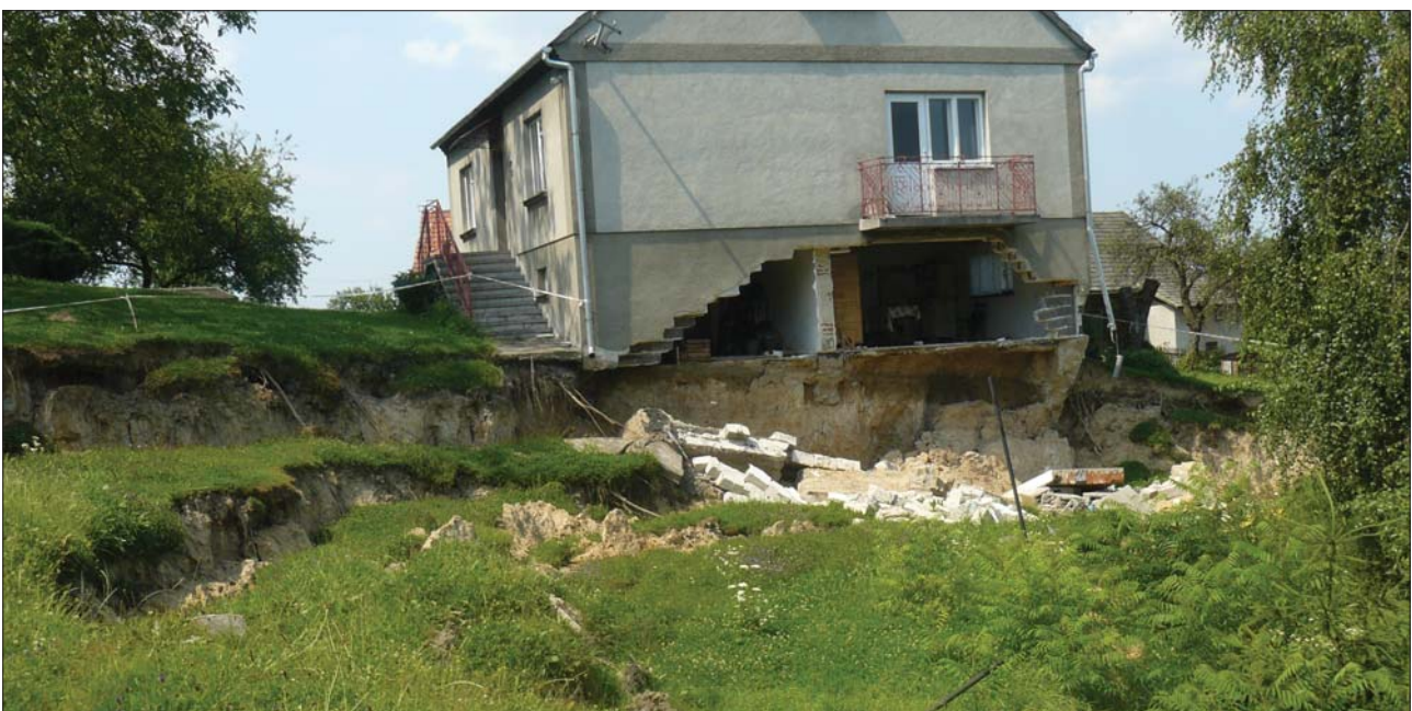
Uszkodzony budynek mieszkalny na osuwisku w miejscowości Nieprześnia (gmina Bochnia, powiat bocheński). Fot. B. Warmuz Damaged residential building on a landslide in Nieprześnia (Bochnia commune, bocheński county). Photo by B. Warmuz
