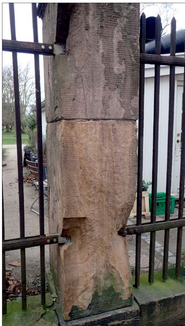
Ryc. 8. Niszczenie elementów żelaznych stymulowane przez sole rozpuszczalne w wodzie, które powodują powstawanie zacieków na powierzchni granitu. Fot. M. Ruszkowski
