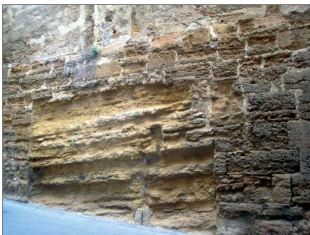
Ryc. 1. Proces deterioracji bloków i wietrzenia w klimacie morskim warstwowanej skały węglanowej, obudowanej murem z bloczków tej samej skały w Agrigento, Sycylia. Obudowany fragment skały ulega wietrzeniu, a ściana deterioracji. Fot. J. Wiszniewska
