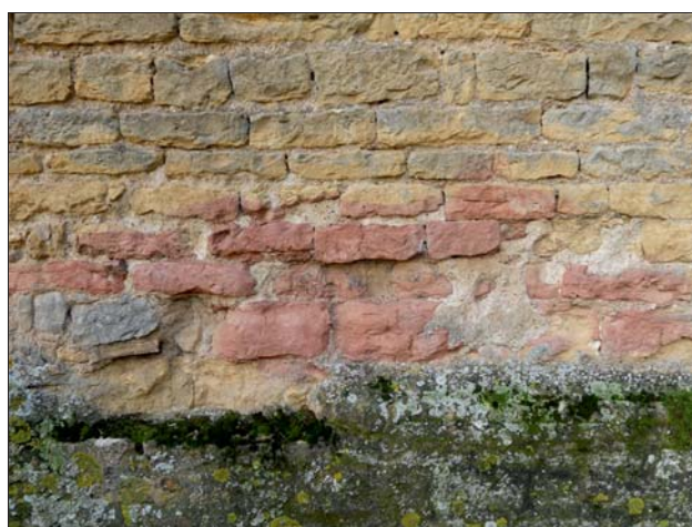
Ryc. 3. Zewnętrzna elewacja romańskiej Bazyliki Najświętszego Serca Pana Jezusa (Basilique du Sacré-Cœur) w Paray-le-Monial (Francja). Wapień w dolnej części ściany ulegający rozpadowi w wyniku działalności pokrywających go mszaków i porostów
