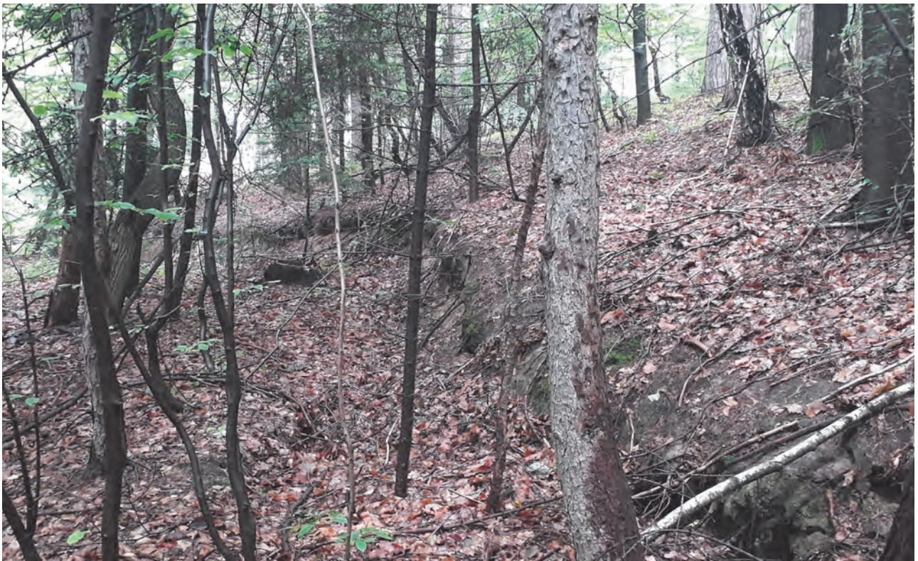
Ryc. 5. Skarpa główna osuwiska w Przydonicy 2, utworzona wskutek opadów w 2010 r. Obie fot. M. Wódka Fig. 5. Main escarpment of the landslide in Przydonica 2, created as a result of rainfall in 2010. Both photos by M. Wódka
