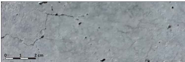
Ryc. 2. Typowe objawy w betonie wywołane potencjalną reakcją alkalia-krzemionka – pęknięcia i mikropeęknięcia. Fot. W. Jasiński Fig. 2. Cracks and microcracks in concrete caused by potential alkali-silica reaction. Photo by W. Jasiński
