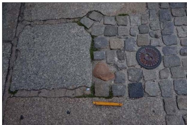
Ryc. 4. Przykład uzupełnień brukarskich zniszczonej płyty chodnikowej na Starym Rynku w Poznaniu
