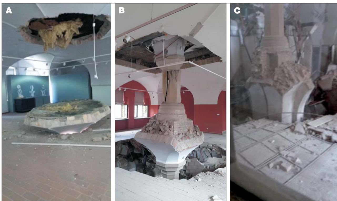
Ryc. 4. Stan filara godzinę po katastrofie: A – na drugim piętrze głowica kolumny wyrwała strop i oparła się na zachowanej posadzce; B – pierwsze piętro – pękł wąski fragment filara z piaskowca; C – na parterze zniszczenia są już poważniejsze, choć kolumny z pierwszego piętra i parteru zachowały się w całości. Poniżej widać zagruzowaną piwnicę. Stan kolumny piwnicznej nie był wówczas znany. Fot. P. Tuzimek (B) i M. Tarnawski (A, C)
