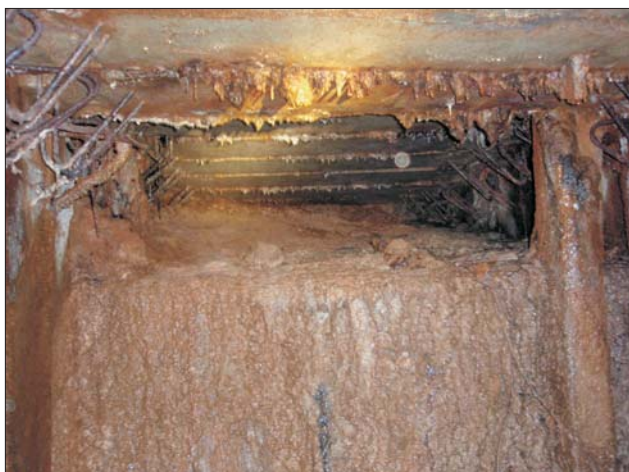
Ryc. 13. Przodek nieukończonego tunelu pod dziedzińcem (zaznaczony zieloną strzałką na ryc. 9) – są widoczne nacieki i stożek napływowy z gruntu naniesionego przez wodę, sedimentacja miała nagły przebieg, o czym świadczy zasięg stropu wykonanej już obudowy w stosunku do położenia prowizorycznego zabezpieczenia z desek (na pierwszym planie). Fot. T. Godlewski
