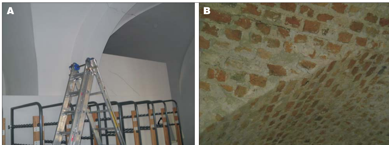
Ryc. 3. Spękania głowic kolumn parteru (A) i piwnicy (B) na kilka dni przed katastrofą. Fot. A. Parszewski
