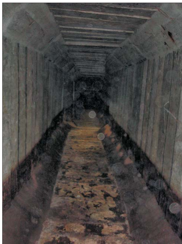
Ryc. 9. Tunel biegnący wzdłuż skarpy północnej – widoczny poziom maksymalnego zalania tunelu. Fot. T. Godlewski Fig. 9. View of the tunnel running along the northern slope – visible level of maximum flooding of the tunnel. Photo by T. Godlewski
