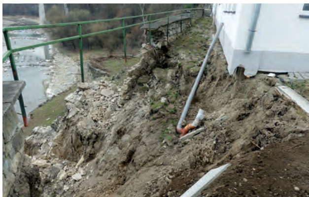
Ryc. 3. Widok na górną część osuwiska w Grybowie. Fot. P. Nescieruk
