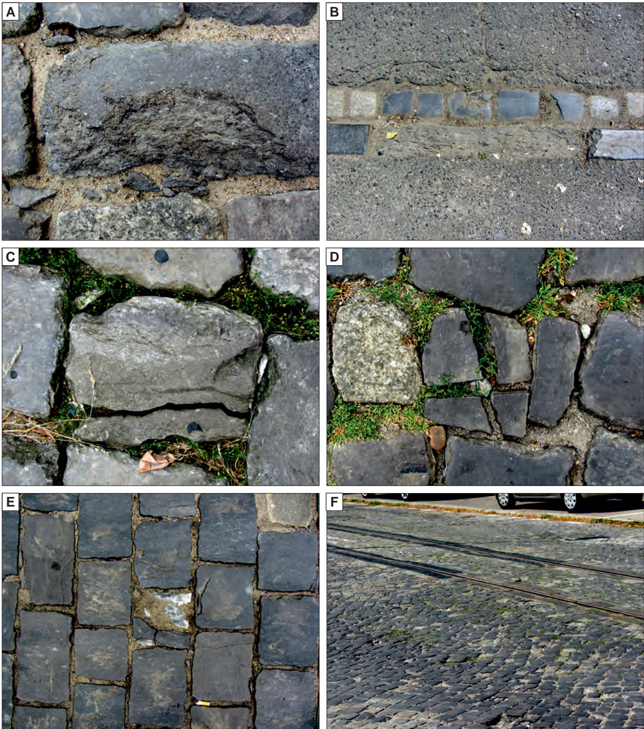
Ryc. 5. Przejawy degradacji nawierzchni wykonanych w Poznaniu z eocenu numulitowego: A – rozpadająca się kostka piaskowca o rozmiarach 35 × 20 cm, Stary Rynek; B – zniszczony krawężnik z piaskowca, sąsiadujący z nim element wykonany z mułowca jest dobrze zachowany, ul. 28 Czerwca 1956 r.; C – pęknięta kostka piaskowca, 12 × 9 cm, ul. Kozia; D – rozpadająca się kostka mułowca, 10 × 10 cm, ul. Zamkowa; E – odsłojenie na powierzchni kostki 15 × 15 cm, wzdłuż powierzchni żyły kalcytowej, ul. Romana Szymborskiego; F – zdegradowana jezdnia ul. Emilii Szymborskiej, z licznymi uzupełnieniami jasnym granitem strzegomskim
