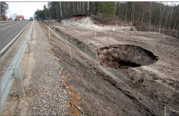
Ryc. 5. Zapadlisko w sąsiedztwie obwodnicy Bolesławia. Fot. J. Kos Fig. 5. A sinkhole near the Bolesław bypass. Photo by J. Kos
