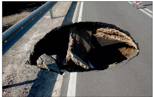
Ryc. 6. Zapadlisko w drodze na obwodnicy Bolesławia. Fot. J. Kos Fig. 6. A sinkhole on the road on the Bolesław bypass. Photo by J. Kos
