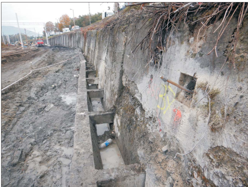
Ryc. 1. Uszkodzenie muru oporowego w Rabce Zdroju. Fot. J. Kos Fig. 1. Damage to the retaining wall in Rabka Zdrój. Photo by J. Kos
