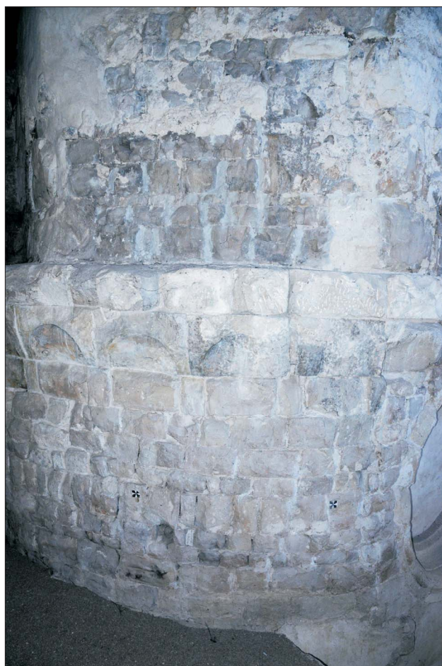
Ryc. 4. Fragment wieży kościoła pw. św. Wojciecha w Jędrzejowie z obtłuczonym fryzem arkadkowym. Fot. J. Bromowicz Fig. 4. Part of the tower of the church of St. Wojciech in Jędrzejów with a chipped arcade frieze. Photo by J. Bromowicz
