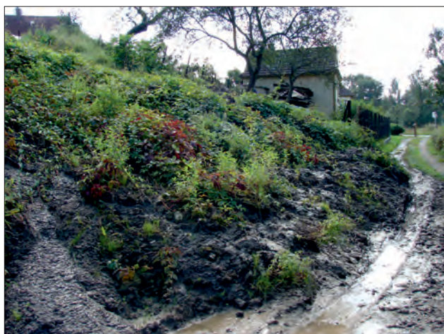
Ryc. 4. Koluwia osuwiska nasuwające się na drogę – rejon ul. Matematyków Krakowskich w Krakowie. Fot. M. Czernek, wrzesień 2010 r.
