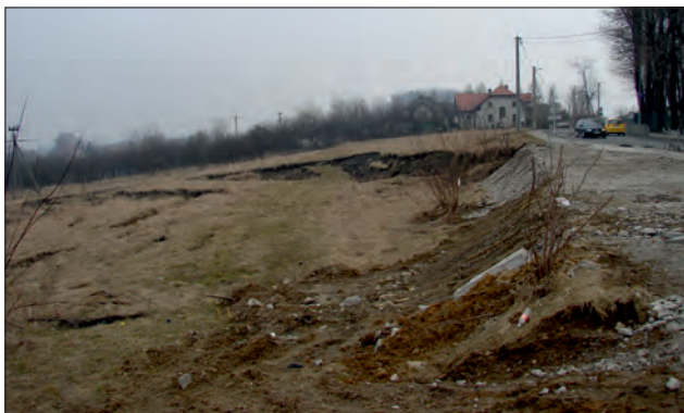
Ryc. 3. Uszkodzona ulica Sawiczewskich w Krakowie. Fot. M. Czernek, marzec 2011 r.
