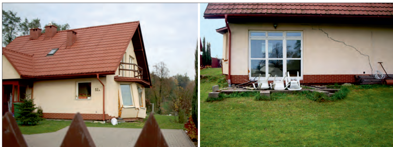
Ryc. 2. Uszkodzony budynek mieszkalny na osuwisku przy ul. Kuryłowicza w Krakowie. Fot. A. Wójcik, listopad 2010 r.
