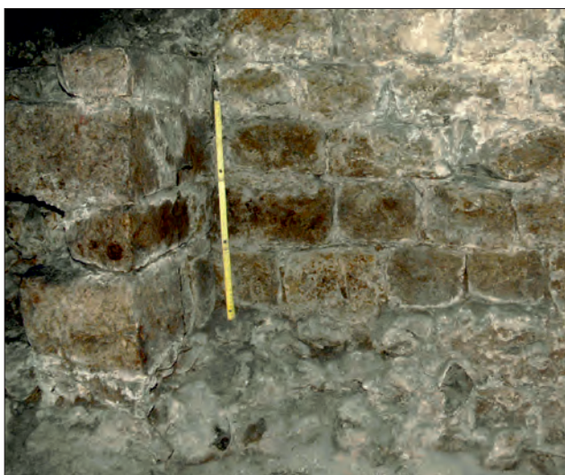
Ryc. 17. Płytki fundament i mur najstarszego Kościoła Najświętszego Salwatora w Krakowie. Fot. J. Magiera Fig. 17. Shallow foundation and wall of the oldest Church of the Holy Saviour in Kraków. Photo by J. Magiera
