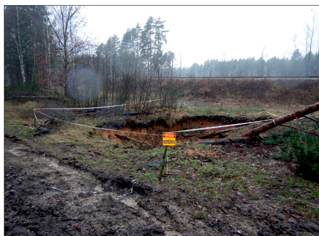
Ryc. 5. Zapadlisko z dnia 7.03.2024 r. (nr 5) w pobliżu nasypu linii kolejowej P205. Fot. S. Kamieniarz, 12.03.2024 r.
