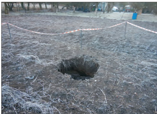
Ryc. 7. Zapadlisko z dnia 29.01.2024 r. (nr 13) przy ul. Grunwaldzkiej. Fot. S. Kamieniarz, 30.01.2024 r.
