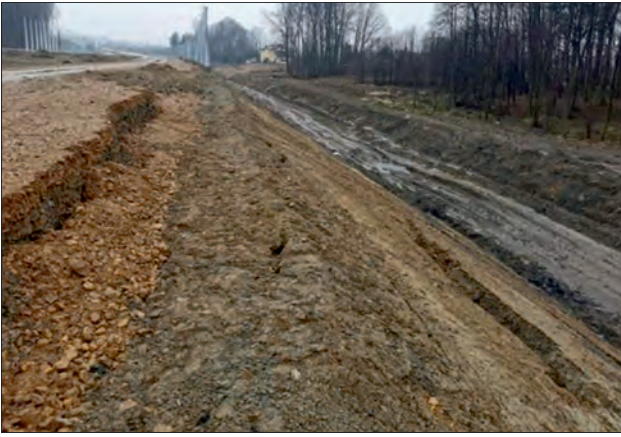
Ryc. 2. Uszkodzony nasyp drogowy. Fot. J. Kos Fig. 2. Damaged road embankment. Photo by J. Kos
