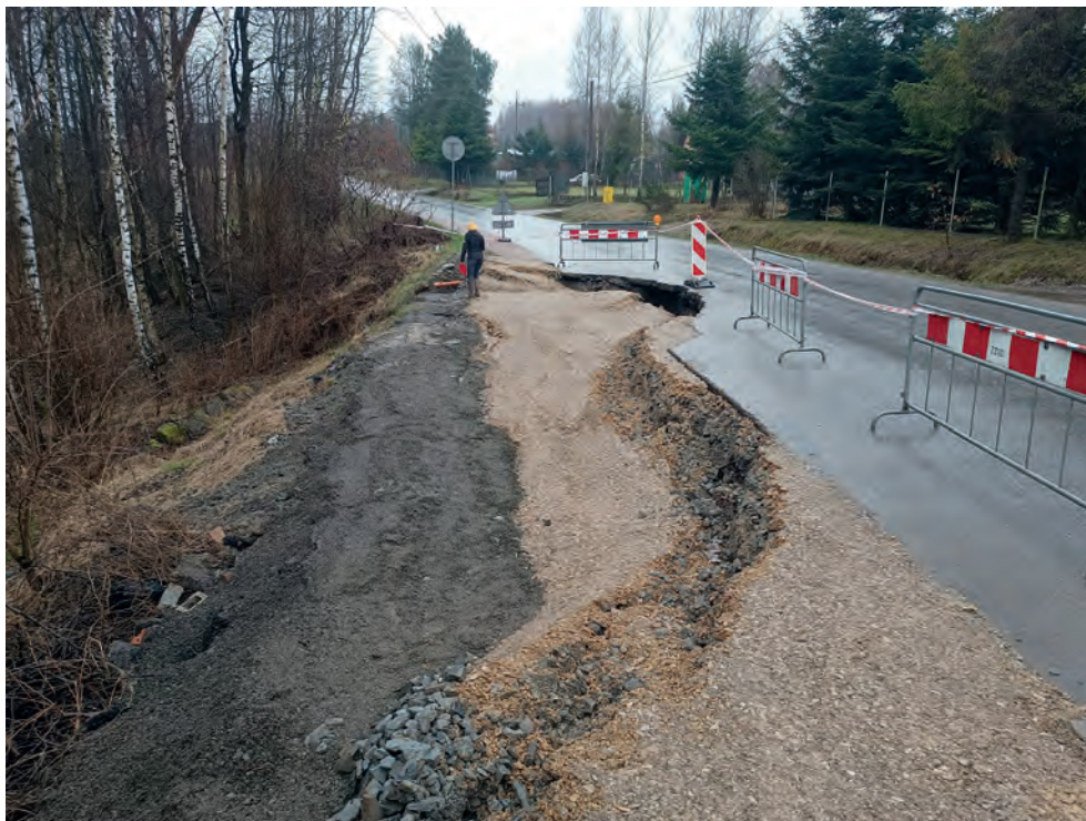
Osuwisko w Sieprawiu, 2024 r. Fot. M. Wódka Landslide in Siepraw, 2024. Photo by M. Wódka
