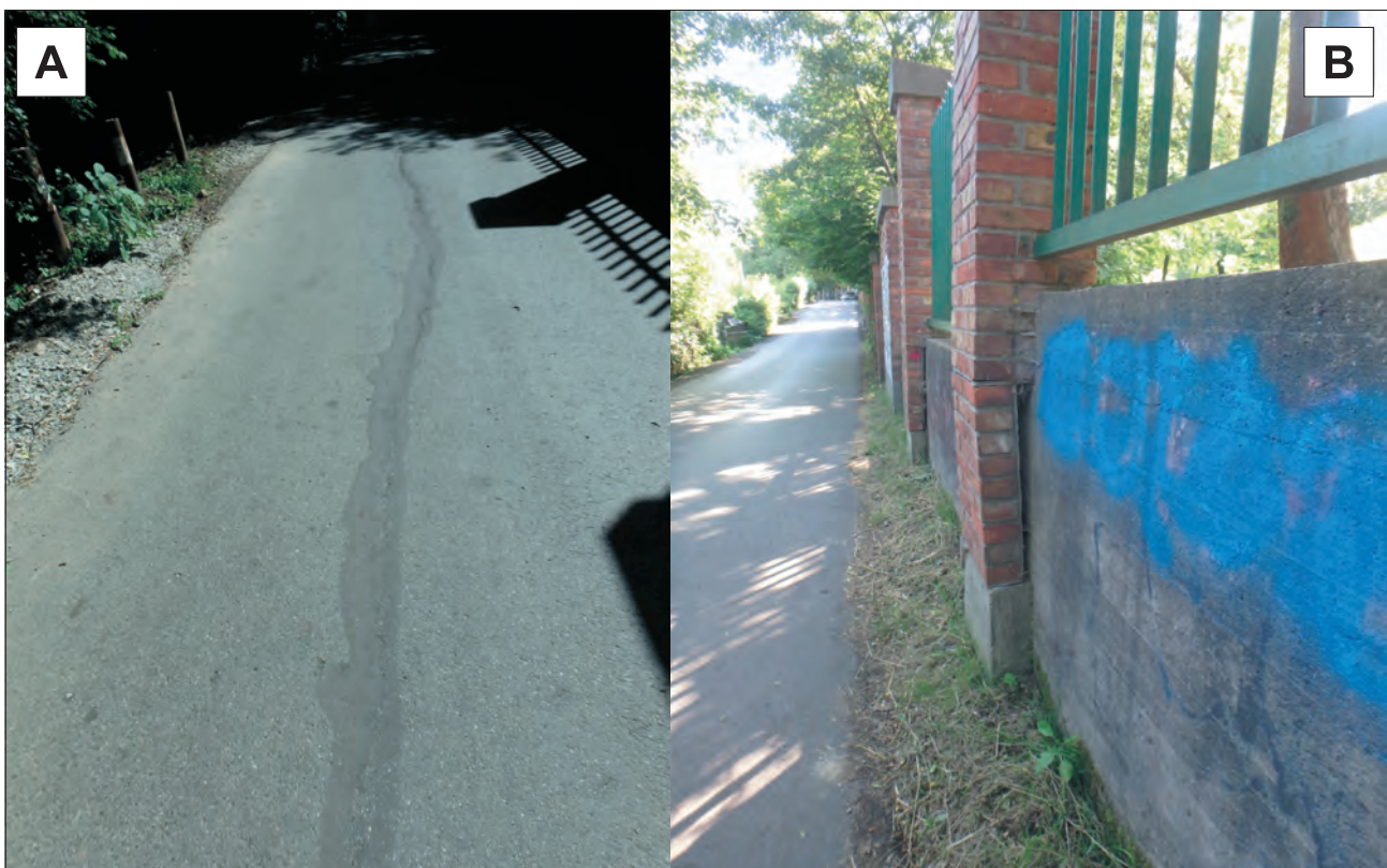
Ryc. 7. Uszkodzenia na ul. Petőfiiego: A – jezdni, lipiec 2020 r.; B – muru Zakładu Uzdatniania Wody, lipiec 2020 r. Obie fot. M. Czernek Fig. 7. Damage on Petőfi Street: A – roadways, July 2020; B – wall of the Water Treatment Plant, July 2020. Both photos by M. Czernek
