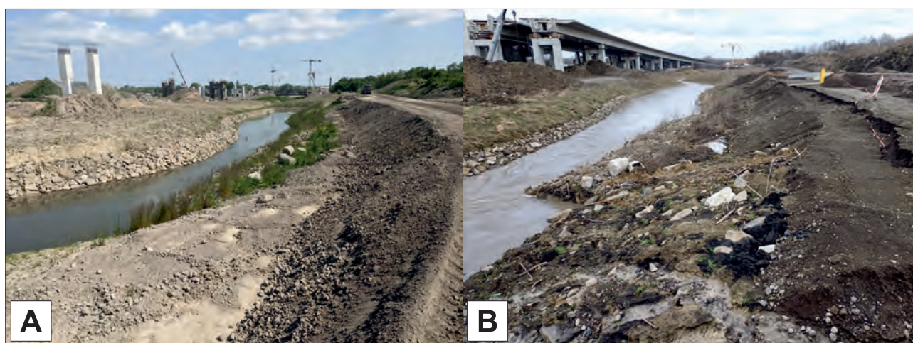
Ryc. 14. Koryto Dłubni: A – jej sztucznie przesunięty lewy brzeg – czerwiec 2023 r.; B – osuwisko i zniszczona droga technologiczna – luty 2024. Obie fot. M. Czernek
