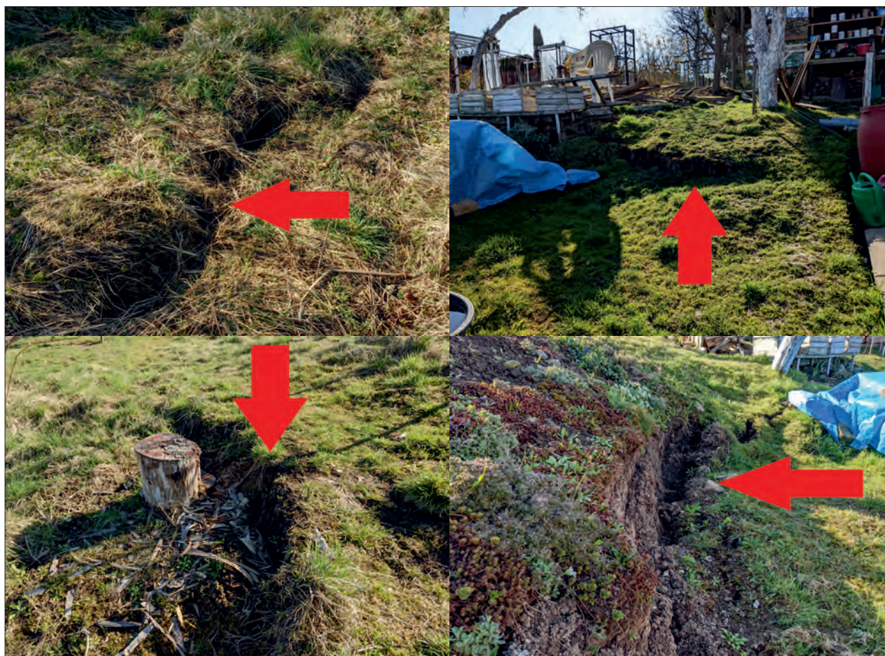
Ryc. 12. Szczeliny osuwiskowe na obszarze Rodzinnego Ogrodu Działkowego Zestawice w Krakowie, 2022 r. Fot. D. Bobrowski Fig. 12. Landslide crevices in the area of the Zestawice Family Allotment Garden in Kraków, 2022. Photo by D. Bobrowski
