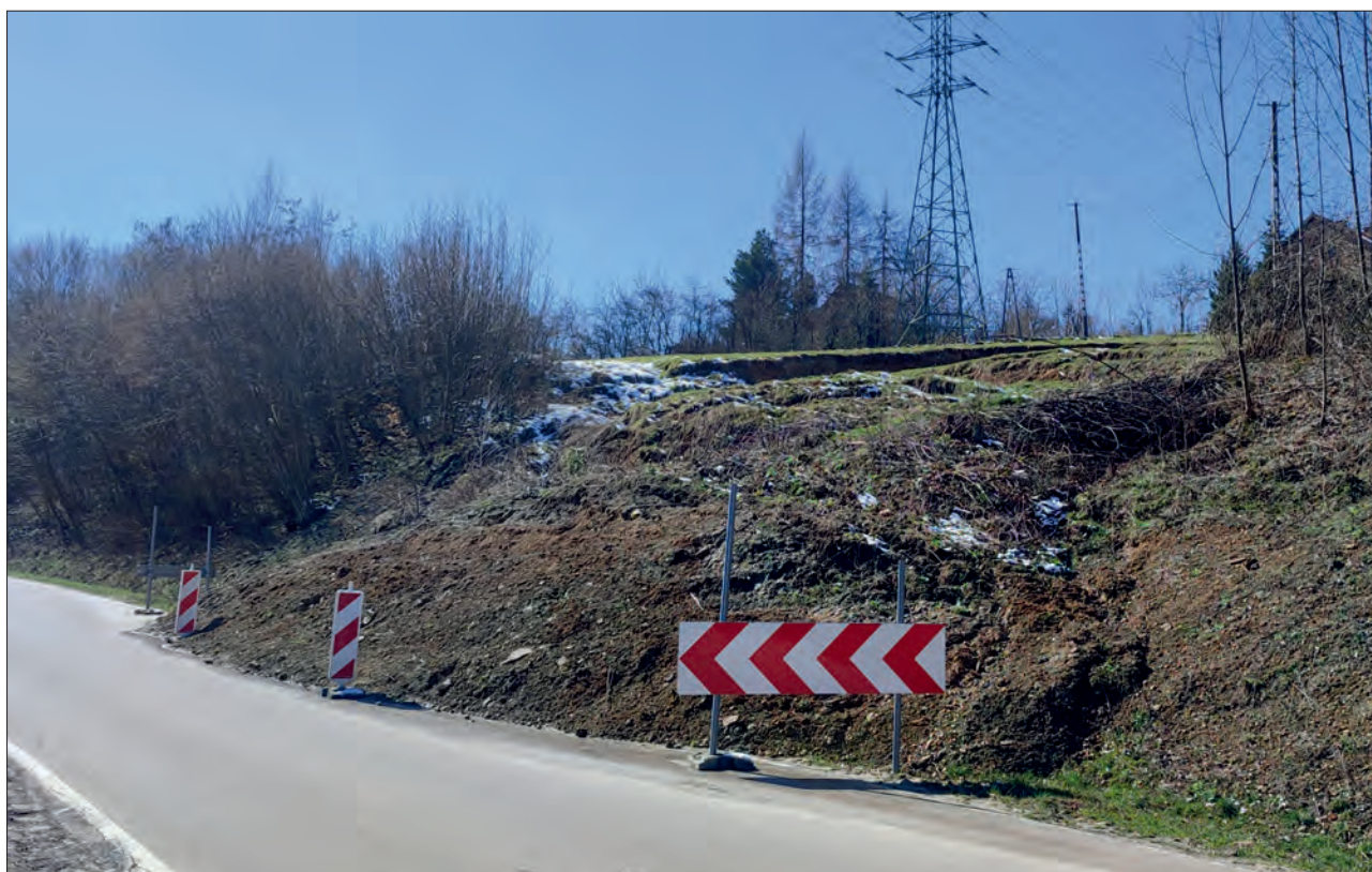
Osuwisko w Rychwałdzie zagrażające drodze powiatowej, marzec 2023. Fot. K. Karwacki Landslide in Rychwałd threatening the district road, March 2023. Photo by K. Karwacki
