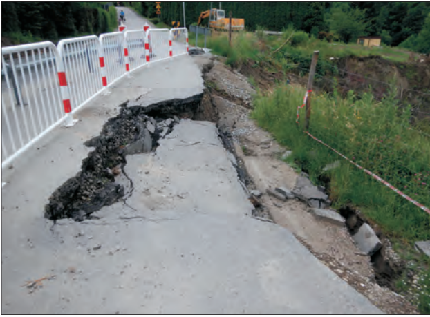
Ryc. 3. Osuwisko w Malawie uruchomione w styczniu 2024 r. Fot. K. Górka
