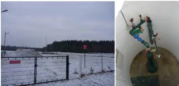
Stacja hydrogeologiczna I/470 Podlesie (woj. śląskie) – widok ogólny terenu stacji i wyposażenie otworów obserwacyjnych numer 2 i 4
