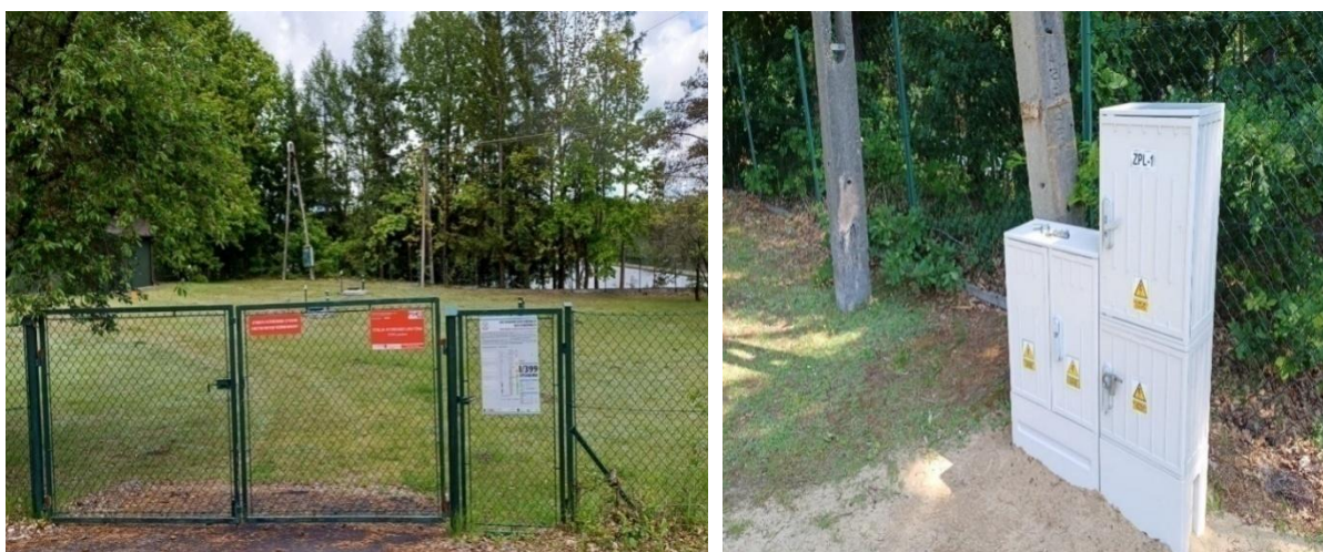
Ryc. 9.6 Stacja hydrogeologiczna I/399 Łysaków (woj. podkarpackie) i zmodernizowane zasilanie instalacji elektrycznej na stacji hydrogeologicznej.
