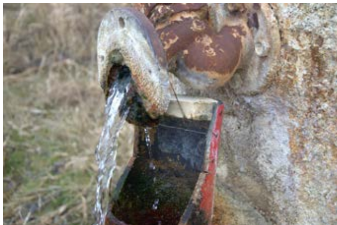
Fot. 5.3.2.2. Głowica i zawór otworu 11R w rejonie Krosnowic, 2023 r. (zdj. M.R. Klonowski)
