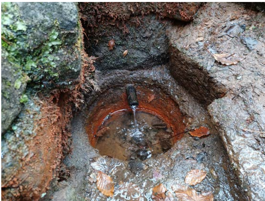
Fot. 5.3.3.2. Obudowa „Źródła Dolnego” w rejonie Nowej Łomnicy, 2023 r. (zdj. A. Krzonkalla)
