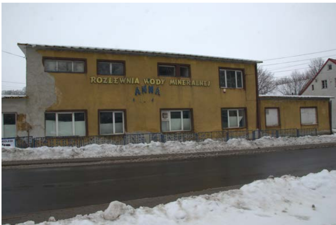
Fot. 5.3.6.1. Budynek byłej rozlewni wody mineralnej „Anna” w Starych Bogaczowicach, 2023 r. (zdj. M.R. Kłonowski)
