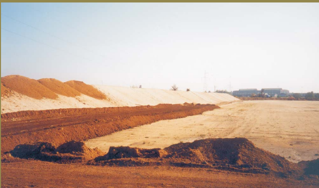
Ryc. 3. Budowa składowiska odpadów niebezpiecznych w Tarnowskich Górach. Formowanie geologicznej warstwy izolacyjnej; fot. A. Drągowski
