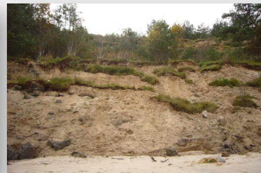
Osuwiska – powstają na klifach o złożonej budowie geologicznej
