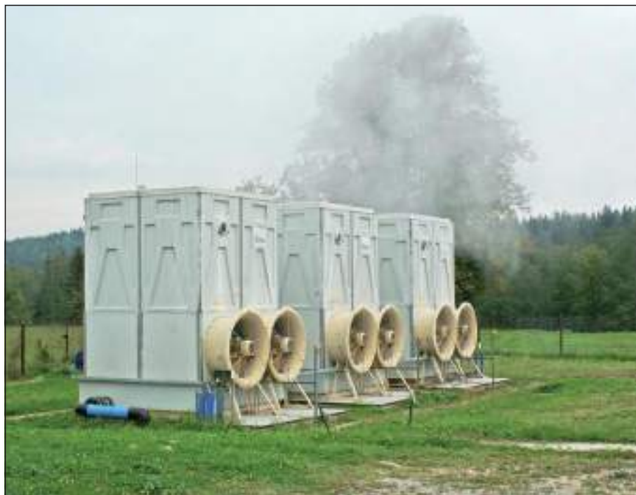
Chłodnia wentylatorowa służąca do schładzania wykorzystanych wód termalnych w Bańskiej Niznej (Geotermia Podhalańska) (fot. J. Sokołowski)
