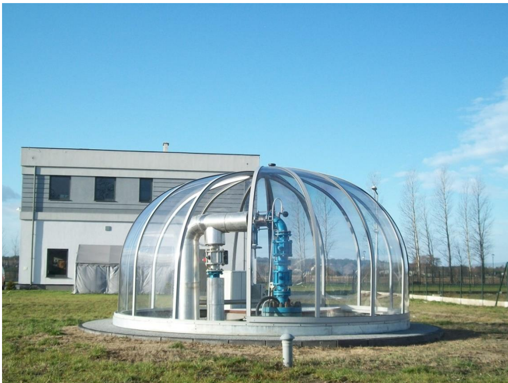
Fot. 3.1.1. Głowica otworu geotermalnego Poddębice GT-2 ( fot. Archiwum Geotermii Poddębice Sp. z o.o. )
