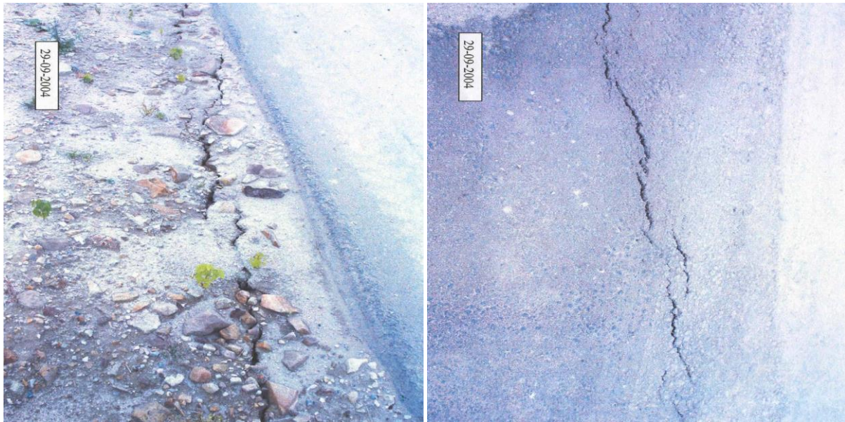
Rysunek 7.18 Uszkodzenia w koronie nasypu oraz nawierzchni autostrady
